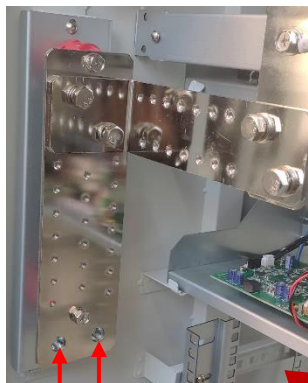
蓄电池正极接线孔 (2个 M10 接线孔)
